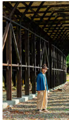
山中ロックシェッドの上部には、信号所の退避線路を守るための構造物も残っています。
